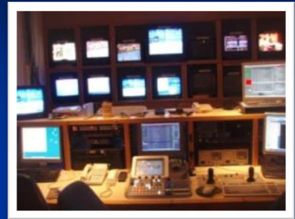
SALA DE CONTROL
